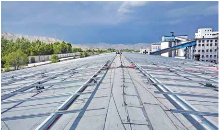
九冶连城铝业光伏项目屋面光伏
